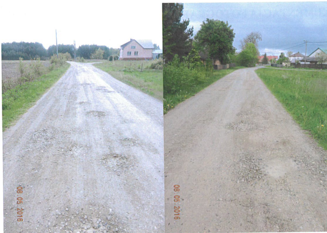
Zdjęcie 5 Droga stanowiąca jedyny dojazd do prywatnych zamieszkałych posesji
